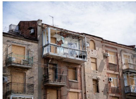
Ein Anblick, dem man in vielen Straßen Charkivs begegnet: Ganze Häuserreihen sind von Raketen zerschossen.
